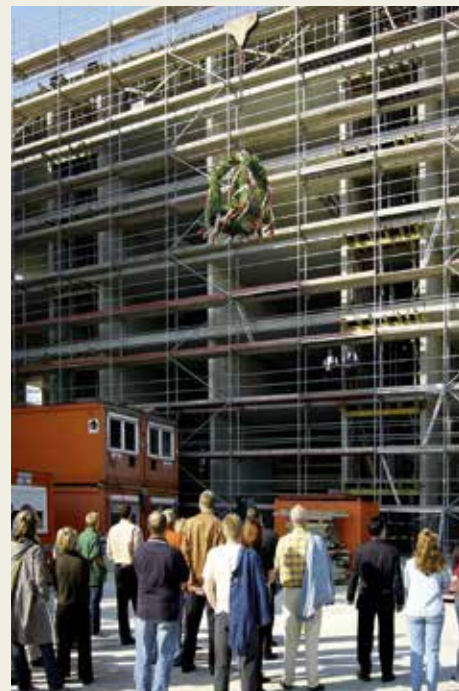
Im September 2005 konnte die Bergedorf-Bille das erste Richtfest in der HafenCity feiern.
