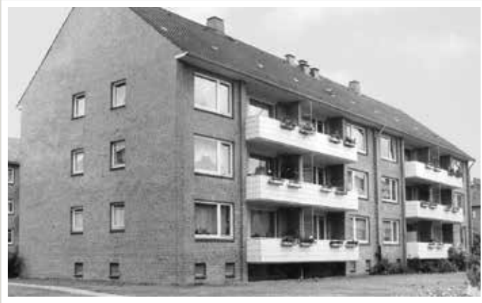
Die Fassade der Wohnanlage wurde 2012 komplett erneuert und mit einem Wärmeverbundsystem versehen.
